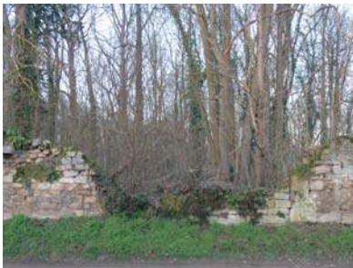
Un mur laissé en l'état après effondrement
